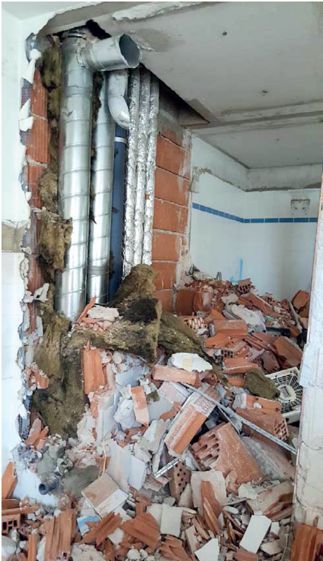
Bsp.: 5_Medienleitungen mit KMF isoliert
