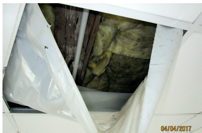
Bsp.: 8_KMF-Matten hinter abgehängter Decke
